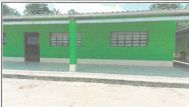
Vista de las paredes y sus puertas ya remozados en la fase posterior de pintura en su interior y su exterior del módulo 2.
