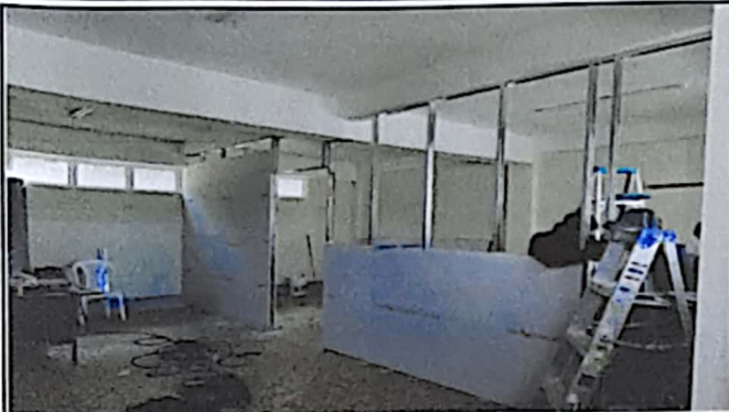
Foto 1: División de ambientes: dirección, bodega y sala de maestros con tabla yeso. En porceso de remozamiento. 31/10/2024
