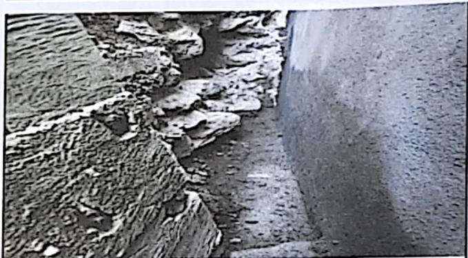
Foto 4: Impermeabilización de paredes en aula de 5to Bachillerato por filtración de agua. En proceso de remozamiento 07/11/2024
