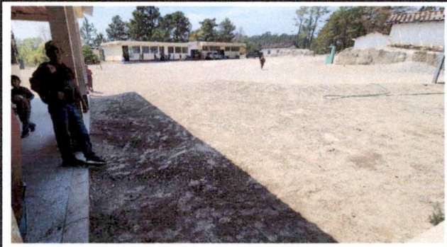
Foto 6: Vista del patio, es necesario colocar una torta de concreto.
