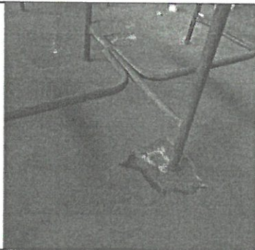
Vista a detalle de daño en piso de aulas
