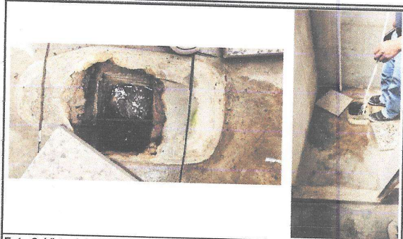
Foto 8: Vista del mal estado de la tubería de los drenajes y agua potable.
