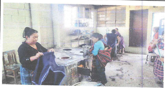
Foto 10: Vista del área de cocina, se observa el piso y las paredes ya deteriorados por el uso.
