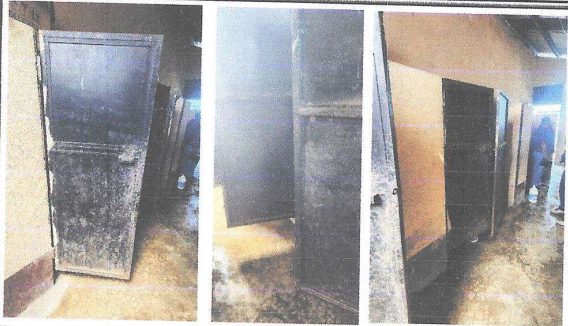
Foto 7: Vista de las puertas en mal estado que se encuentran en los baños.
