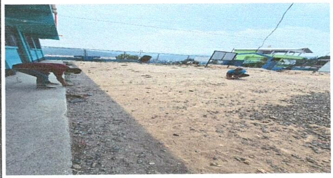
Foto 2: Vista del patio educativo en mal estado, sin pavimento.
