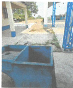
vista de pila en mal estado y espacio a pavimentar
