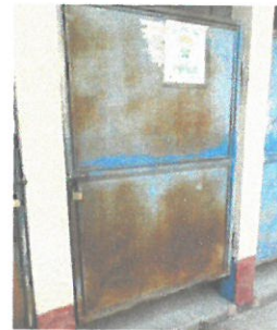
vista de puertas en mal estado
