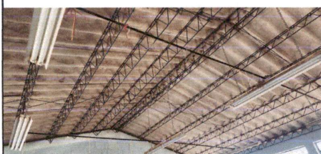
Foto 3: Vista interior de modulo 2, lamina existente de fibrocemento, se encuentra en mal estado. La estructura portante es tipo jois, necesario darle mantenimiento.
