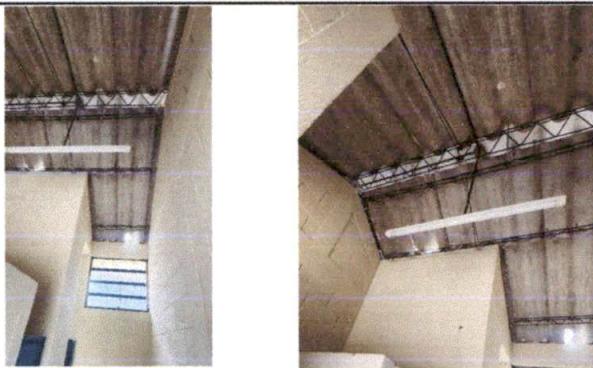
Foto 9: Vista interior del baño, se observa la estructura portante y cubierta de lamina están en mal estado.
