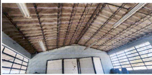
Foto 4: Vista interior de modulo 2, lamina existente de fibrocemento, se encuentra en mal estado.
