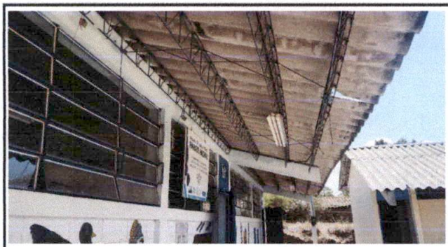
Foto 5: Vista del pasillo del modulo 2, lamina existente de fibrocemento, se encuentra en mal estado.
