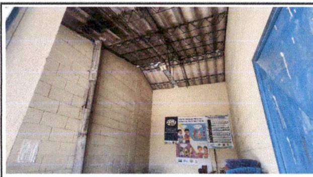
Foto 6: Vista interior de modulo 2 en área de cocina, lamina existente de fibrocemento, se encuentra en mal estado.
