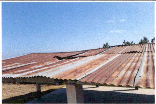
Foto 8: Vista de la cubierta existente está en mal estado.
