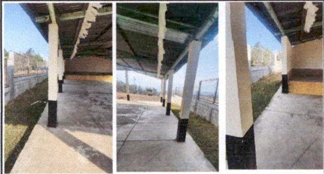
Foto 7: Vista de columnas, están desplomadas, siendo peligrosas.
