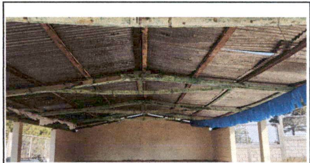
Foto 10: Vista interior del sum, la estructura soporte de madera y la cubierta de lamina existente está deterioradas y en mal estado.
