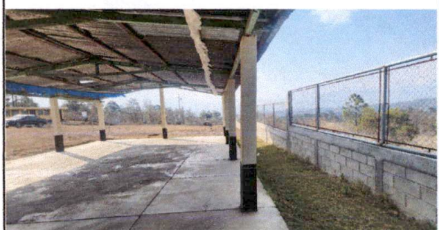
Foto 6: Vista de columnas, están desplomadas, siendo peligrosas.
