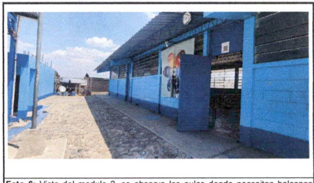
Foto 6: Vista del modulo 2, se observa las aulas donde necesitan balcones metálicos, debido a la inseguridad del lugar.
