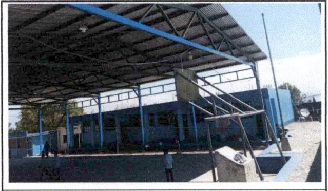
Foto 2: Vista del modulo 1, se observa las aulas donde necesitan balcones metálicos, debido a la inseguridad del lugar.
