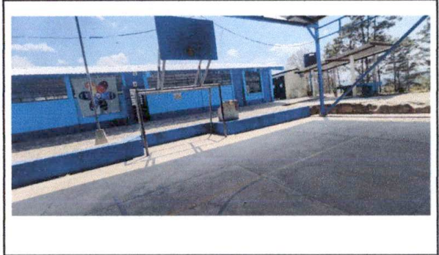
Foto 4: Vista del modulo 2, se observa las aulas donde necesitan balcones metálicos, debido a la inseguridad del lugar.
