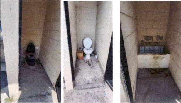
Foto 10: vista del interior de los baños, se cambiarán inodoros, se colocara nueva tubería de drenaje.
