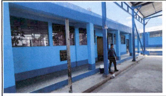
Foto 3: Vista del modulo 1, se observa las aulas donde necesitan balcones metálicos, debido a la inseguridad del lugar.
