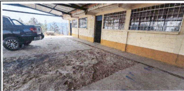
Foto 9: vista del mal estado del piso del patio.
