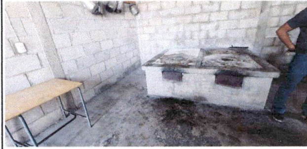
Foto 4: vista del mal estado del piso de la cocina.
