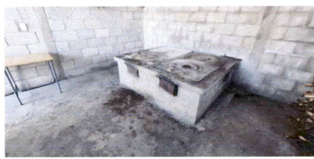
Foto 3: vista del mal estado del piso de la cocina.
