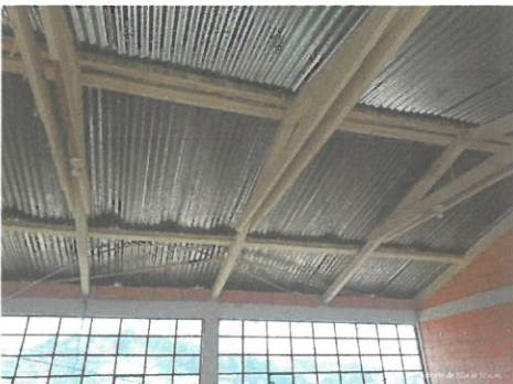
Foto 3: Vista inferior e interior de techo a sustituir en aula de tercero básico.
