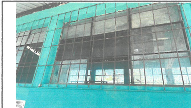
Foto 1: REMODLACION DE BALCONES, YA QUE ESTA ESTÁ, EN MAL ESTADO
