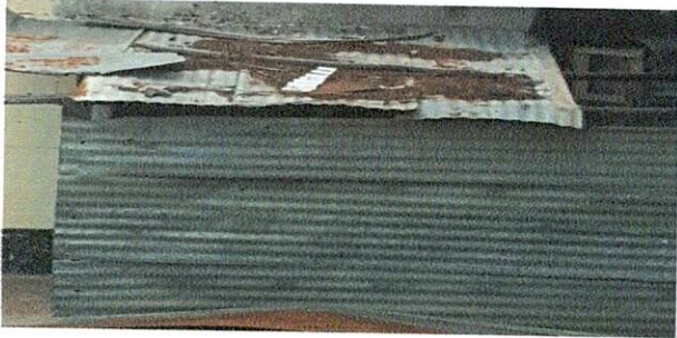
Foto 1: láminas en bodega en mal estado.
