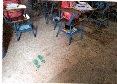
Foto 2: Piso actual de cemento.
