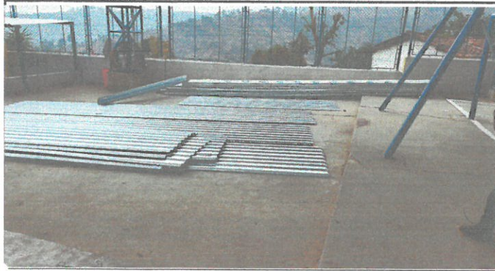
Foto1: MATERIAL DE TECHO A REMOSAR
