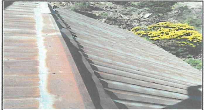
Vista de techo deteriorado a remozar.
