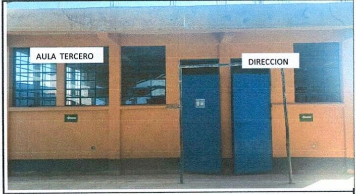
Vista del aula de tercero primaria y dirección, para la instalación de valcones.
