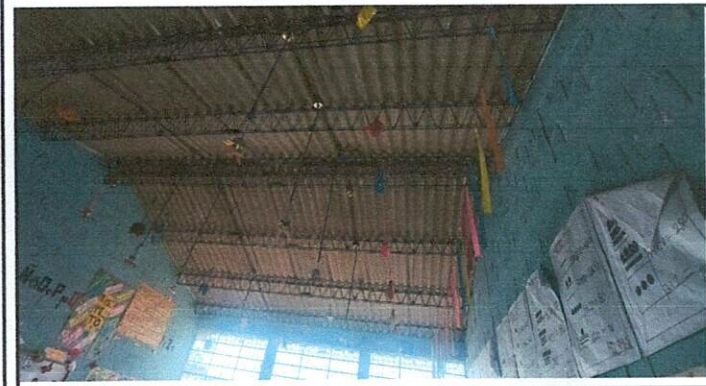
Vista interior, de las aulas para el cambio de techo de duralita a lámina troquelada calibre 26
