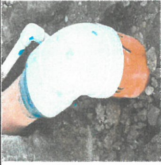
Foto 4: Conductión de desagüe de agua pluvial.
