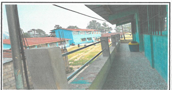
Foto 6: Remozamiento de baranda en el segundo nivel, columnas de concreto y tubos galvanizados.
