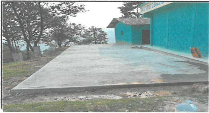
Foto 1: Remozamiento piso de tierra alrededor del INEBT con concreto de 10cm de espesor.
