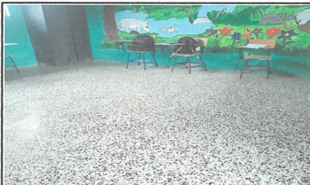
Foto 3: Sustitución de piso de cemento por piso de granito lustrado, aula de 3ero. Básico.
