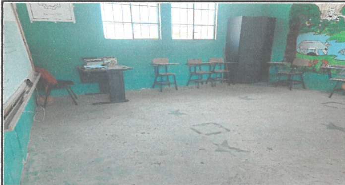
Foto 3: Sustitución de piso de cemento por piso de granito lustrado, aula de 3ero. Básico.
