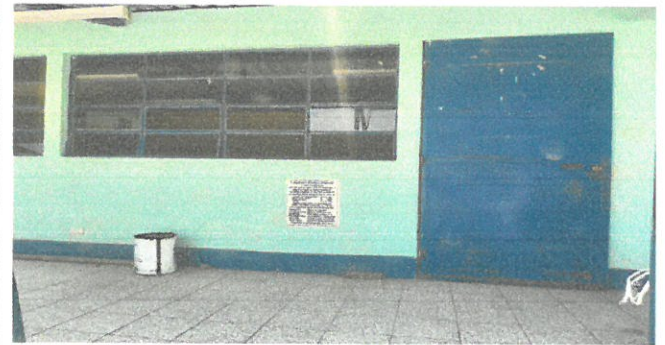
Vista del area con la necesidad de balcones y reposicion vidrios para las ventanas
