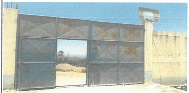
Vista del area donde se necesita limpieza, reparación y pintura para las puertas
