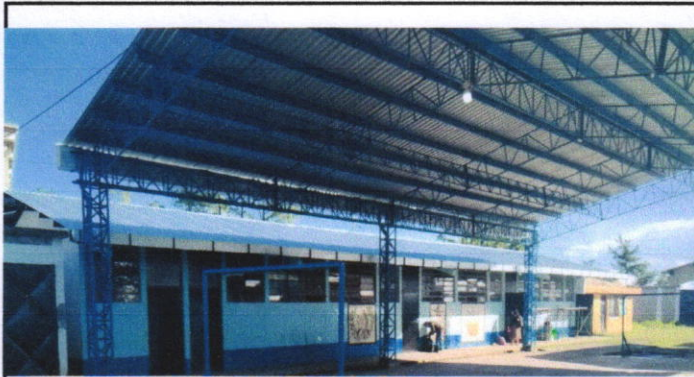
Foto 1: Vista de la cubierta del techo, este módulo de tres aulas y baños de niñas y niños se cambio de láminas.
