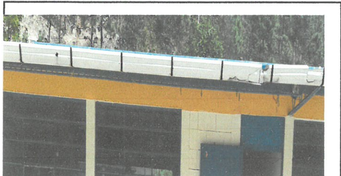
REGLON DE CANALETAS ANTES
