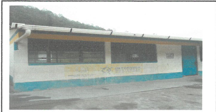
REGLON DE TRABAJO ANTES DE LA EJECION DE TERIODO DE LA PINTURA DE AULAS.
