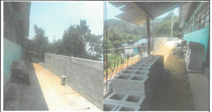
Foto 3.1: Pavimento cercano al muro de contención módulo 1
