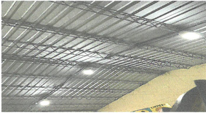
Vista de area de sistema eléctrico finalizado.
