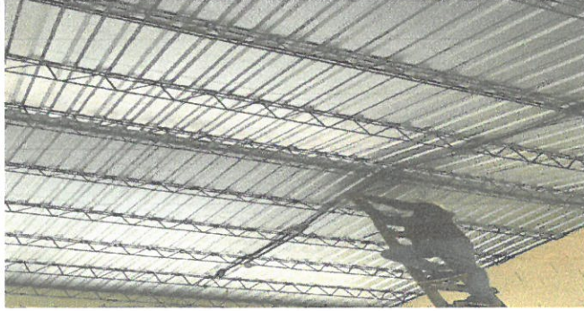
Vista de area de sistema electrico en proceso a remozar.
