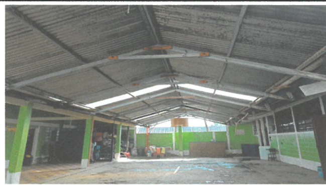
Foto 4: Vista de área de laminas deterioradas a remozar.
