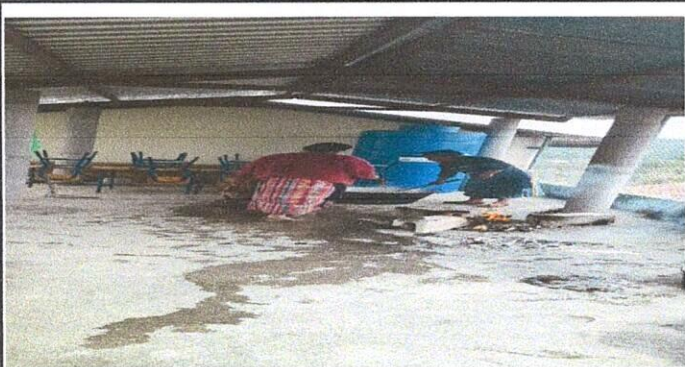
Foto 3: Cambio de estructura del techo de madera por tubo galvanizado de 4x4
