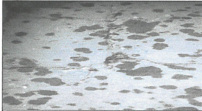
FOTO 1: Cementado de aula en mal estado
