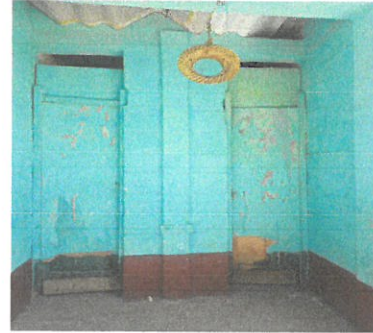
Vista de puertas deterioradas a remozar.
