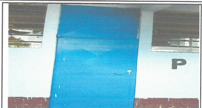
Foto 2: Vista a la cubierta de cambio de chapa y pintada de puertas.
