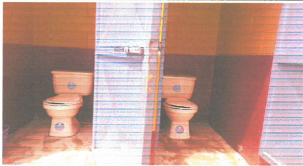
Foto 3: Vista frontal de los inodores de doble descarga.
