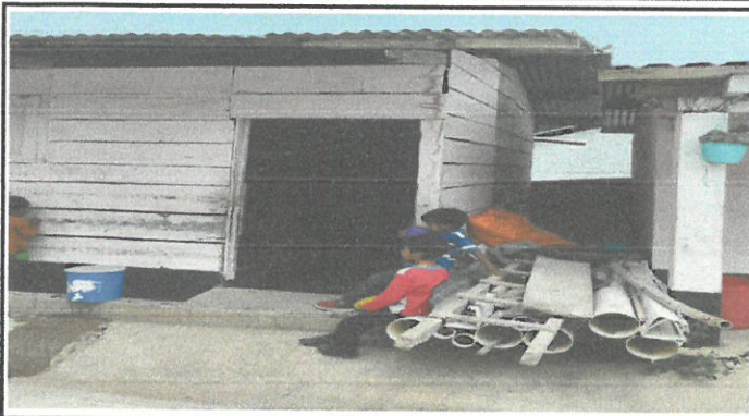
Foto 1: Paredes en mal estado
