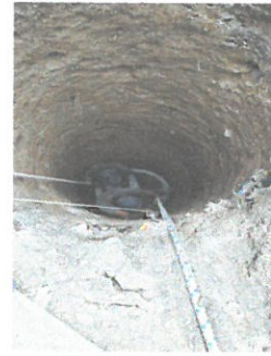
FOTO 4: Pozo de absorción de 10 metros de profundidad.
