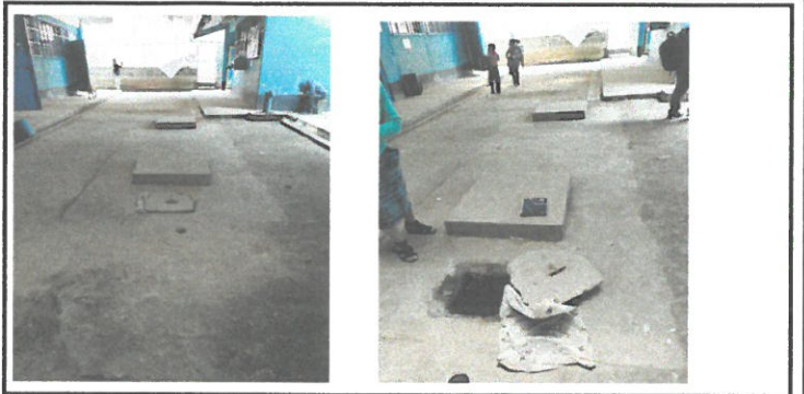
FOTO 2: En esta imagen se observa las tapaderas de la fosa séptica en mal estado, debido a ello por las mismas se escapa el mal olor derivado del tratamiento de la misma.
