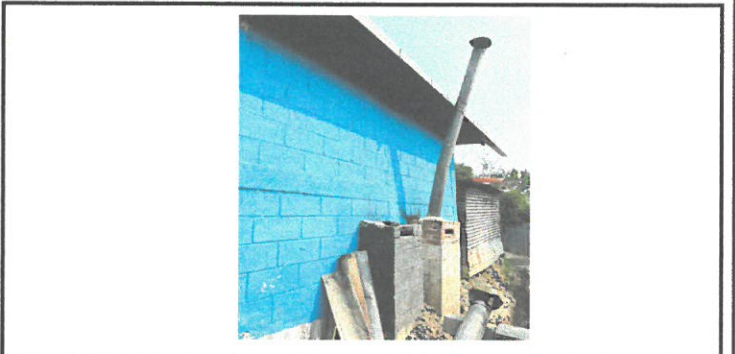
Foto 4: La chimenea no cuenta con salida eficaz, al utilizar las hornillas de la plancha para preparar alimentos la cocina se llena de humo.
