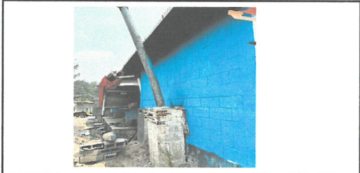
Foto3: Parte de atrás de la cocina, la chimenea se encuentra despegada de la pared en la base lo que provoca que no funcione en su totalidad.
