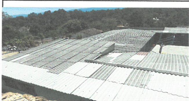
Se necesita cambiar el techo total del establecimiento
