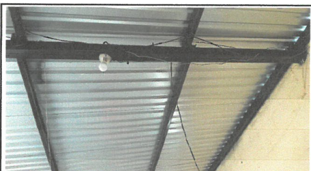
Los cables de la instalación eléctrica ya se encontraban deterioradas.
