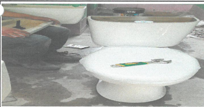
Instalación de sanitarios lavables de niñas y niños
