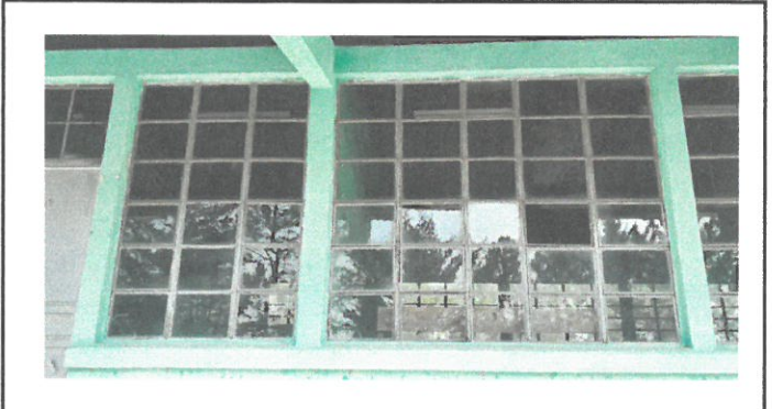
Vista de ventanas quebradas a remozar
