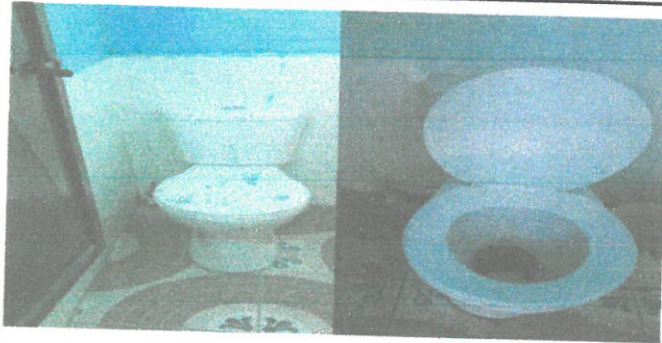
Baños a remozar en mal estado
