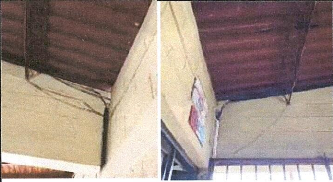
MUROS CON FISURAS
