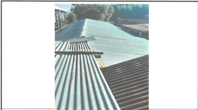
Foto de área a remozar de techo
