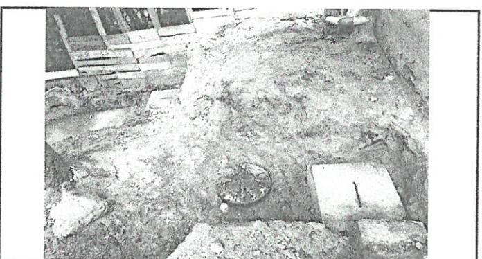
Foto 6: Biodigestor instalado y con sus respectivas cajas de limpieza.
