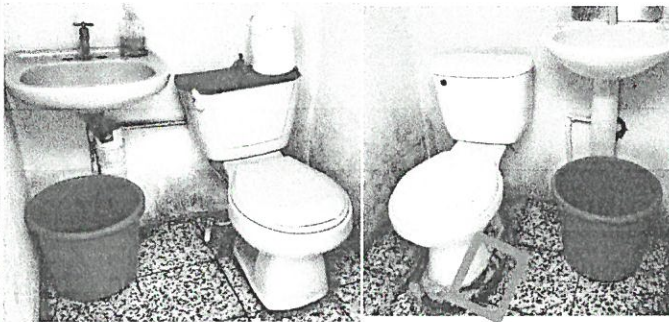
Foto 3: Cambio por fisura y goteo de agua
