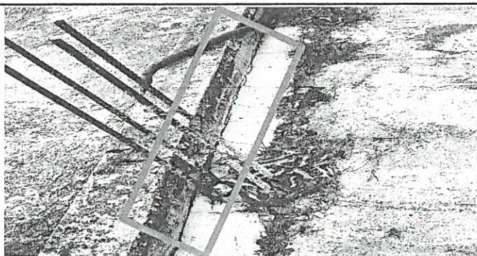
Foto 5: Filtaración de agua en losa, columna y caída de agua.
