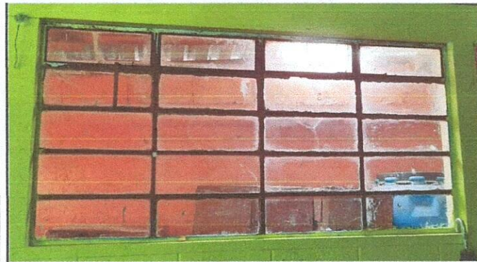
Foto 3: Ventana fijas y en mal estado, modulo 1
