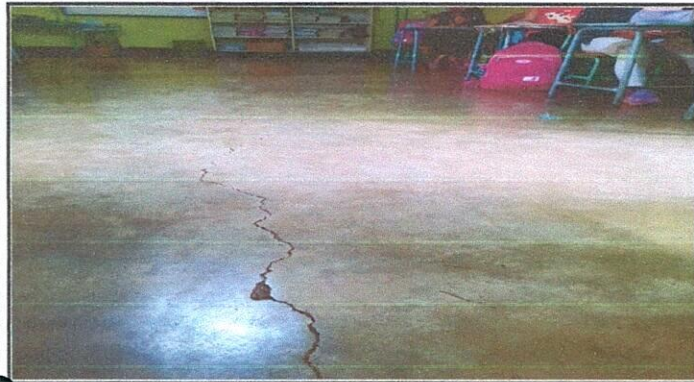
Foto 1: Piso actual torta de cemento alizado en mal estado modulo 1
