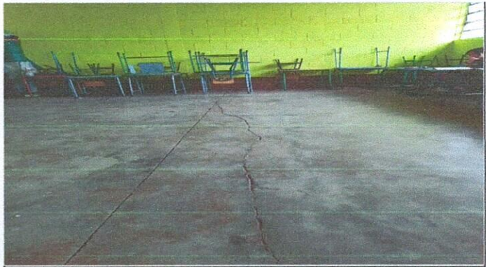
Foto2: piso actual torta de cemento alizado en mal estado modulo 2
