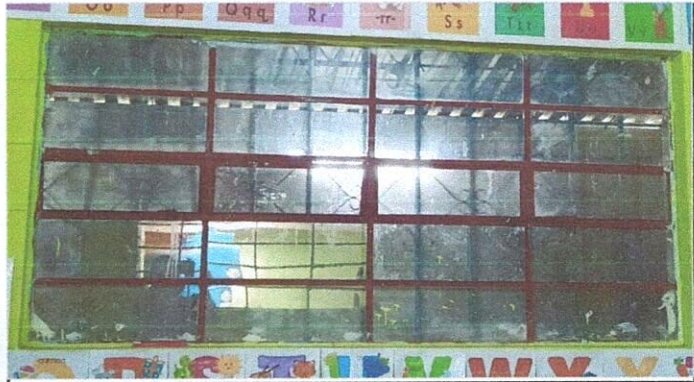
Foto: 4 Ventana fijas y en mal estado, módulo 1
