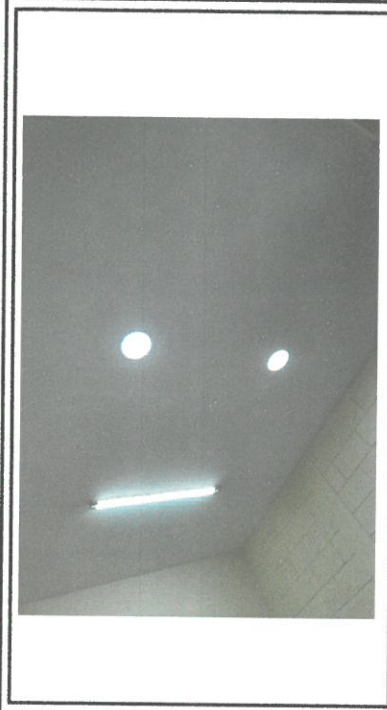
Foto 8: Suministro e intalación de cielo falso de tablayeso. Suministro e instalación de luminaria tipo ojo de buey. En dirección.
