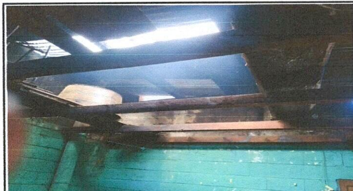
Foto 3: Interior mal ubicado sistema electrico.
