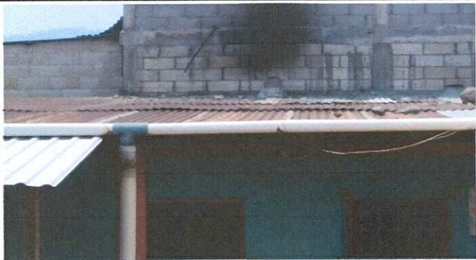
Foto 1: Techo de la cocina que ya presenta deterioro y requiere cambio. De igual manera el cambio de vigas.
