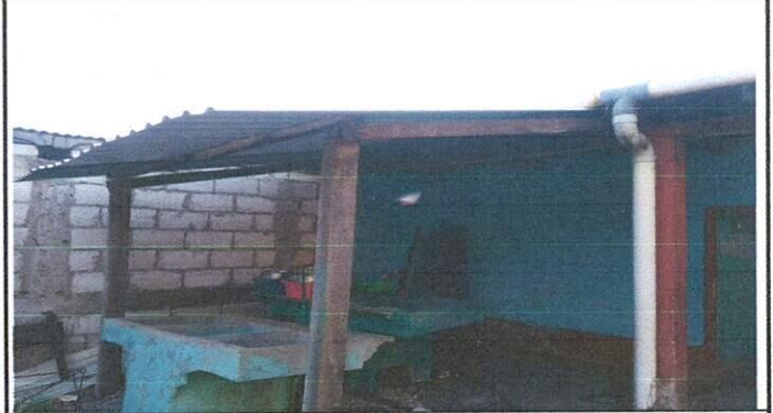
Foto 2: Exterior de la cocina requiere mejoramiento.
