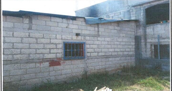
Foto 2: Exterior de la cocina que requiere repello y mejoramiento.
