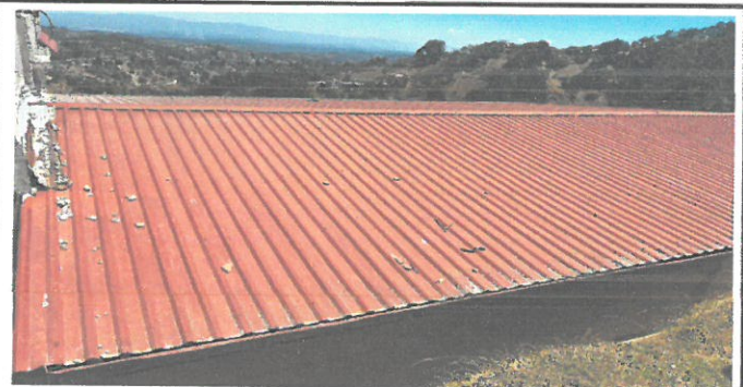
Vista de techo a cambiar por filtración de agua
