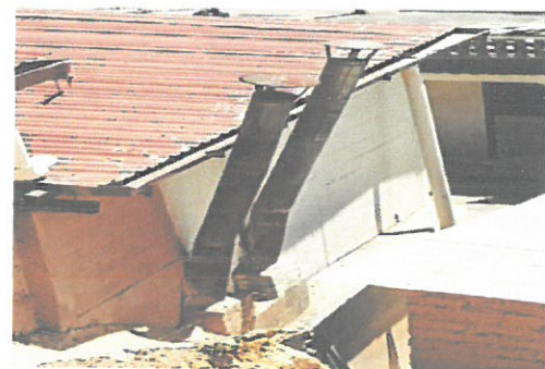
Vista de chimeneas en deterioro de la cocina a remozar
