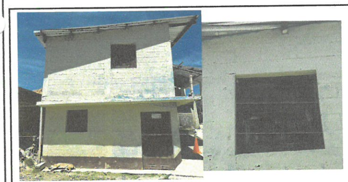
Vista de ventanas en deterioro de dirección y bodega
