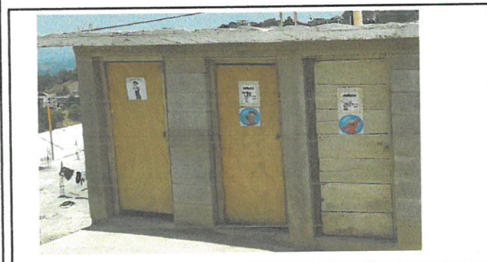
Vista de puertas de baño a sustitir
