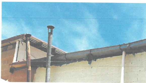
Vista de chimeneas en deterioro de la cocina a remozar
