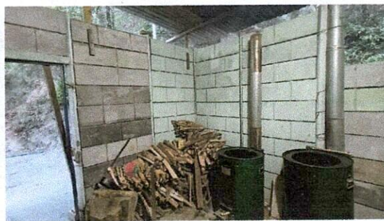
Foto 4: Repello de cocina
