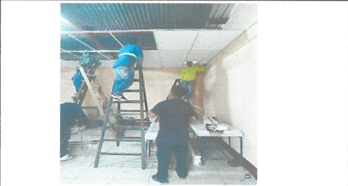
Fotos de area a remozar cielo falso en direccion
