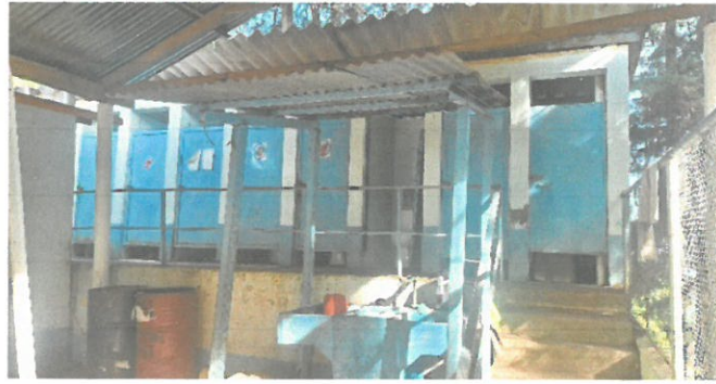
El modulo de los baños presenta desprendimiento con inclinación al norte, por tal razon se la requiere la reconstrucción de la misma.
